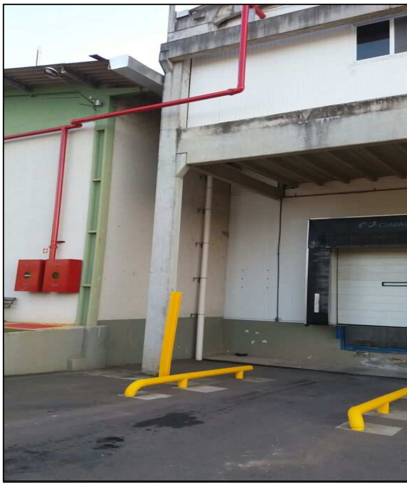
Figura 10 - Local onde foi detectado grande volume de água
